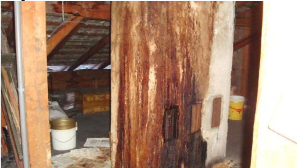
Dachgeschoß – versotteter Kamin
