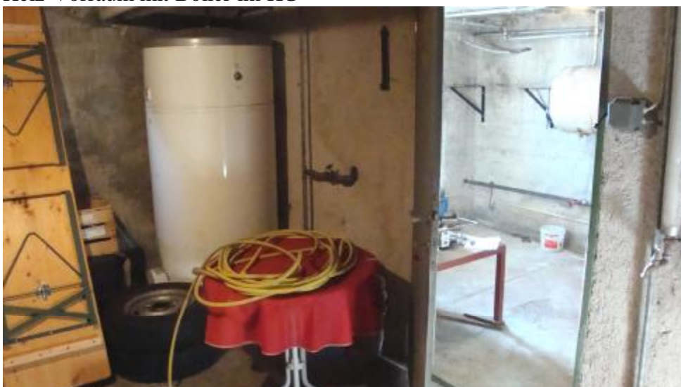
Heiz-Vorraum mit Boiler im KG
